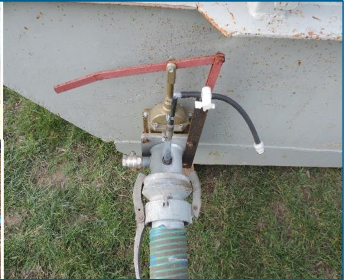
Einspülschleuse für Säure
