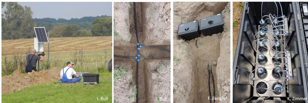
Abbildung 3: Zentralstation mit Solarpaneel (links); Unterdruckleitung im Graben (Mitte links); Sammelkisten mit Druckleitung (Mitte rechts); geöffnete Sammelkiste mit über eine Hahnenbank an die Druckleitung angeschlossenen Sammelflaschen (rechts).
