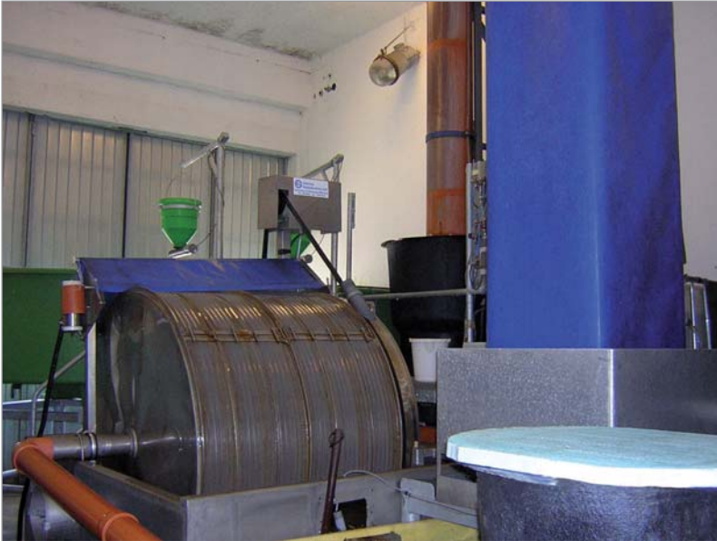
Bild 2: Ein Trommelfilter für die mechanische Reinigung des Kaltwasserkreislaufes in Hohen Wangelin mit Blick auf die Kaskade und den Biofilter
